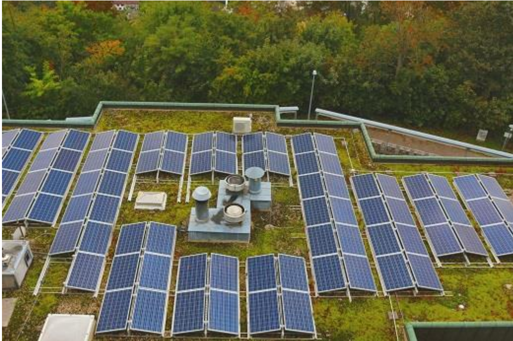
Exemple d'installation photovoltaïque en toit terrasse végétalisé, crédit photo Cerema
