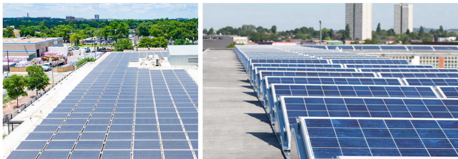
Panneaux solaires sur toitures
