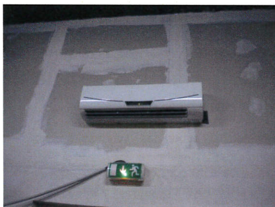
Climatisation dans local technique
