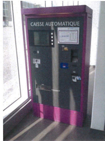
Nouvelle caisse de péage
