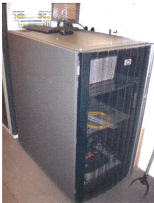
Renforcement et sécurisation du serveur péage
