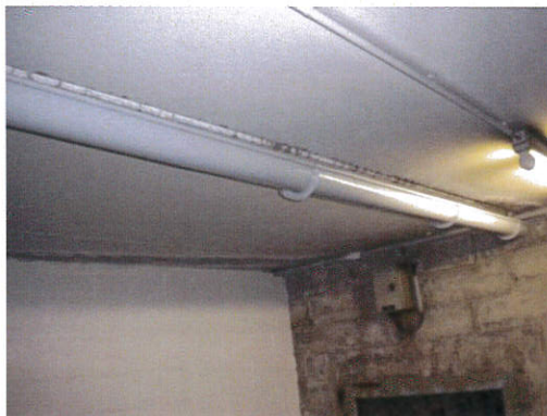
Evacuation des eaux de ruissellement
