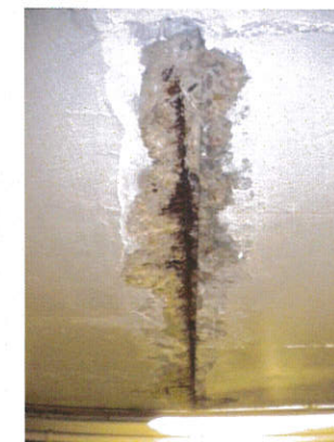
REPRISE D'EPAUFREAU AU PLAFOND
